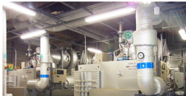
ターボ冷凍機 (大阪、グリーンゼタワー)
