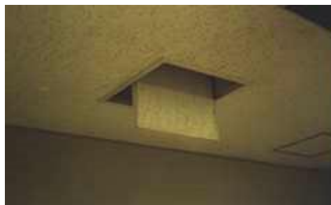
煙拡散防止のための排煙口
